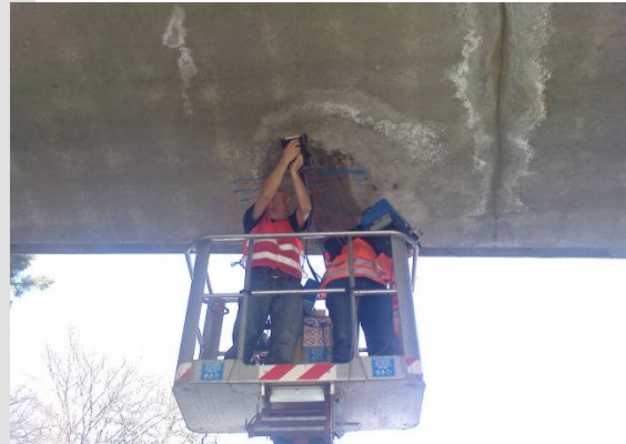
Auscultation non destructive d'un pont; localisation des armatures et de la précontrainte
